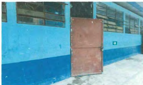
Foto 1: Sustrución de puertas de metal por encontrarse en mal estado y deterioradas en su estructura que ameritan intervención.
